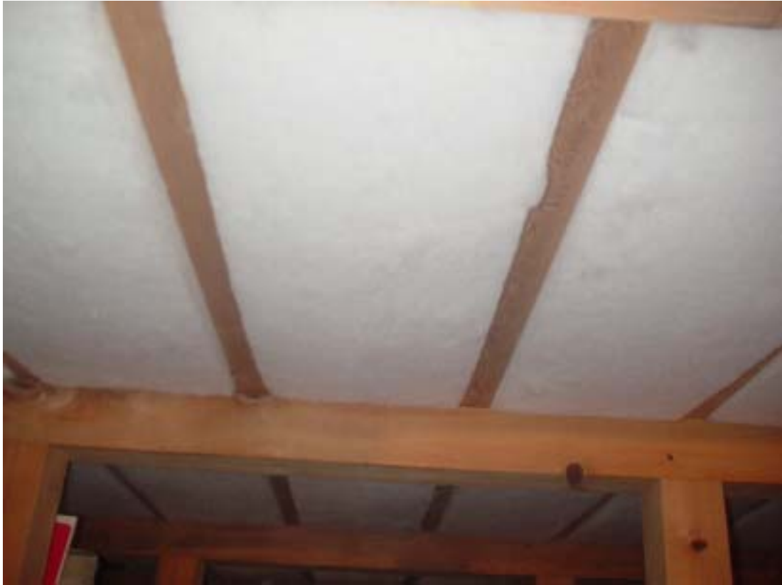
断熱材設置工事（床暖房パネルの下に断熱材をセットします）
